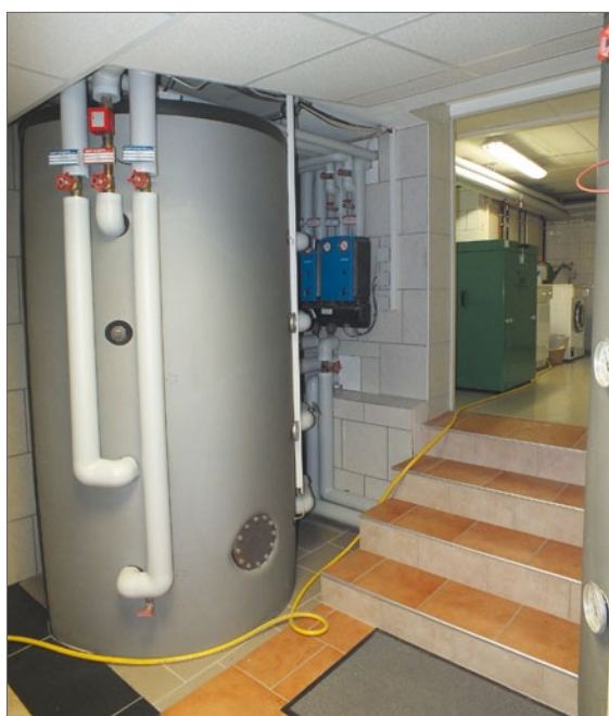
Zwei große Pufferspeicher im einen Meter tiefer ausgehobenen Kellerbereich; das BHKW im alten Heizkeller (hinten).
